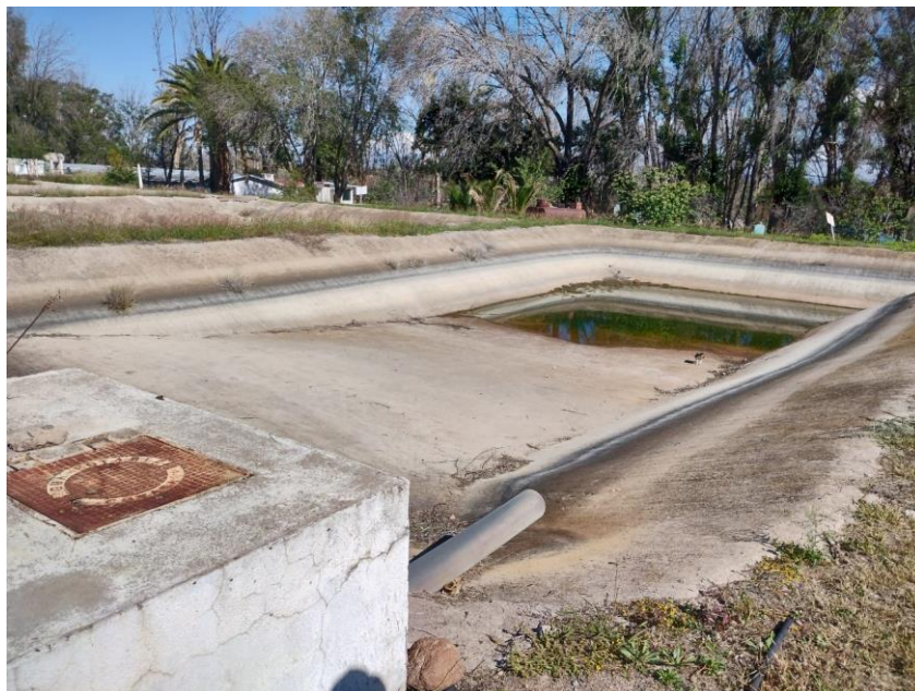
Figura 13. Estanque de cemento.
